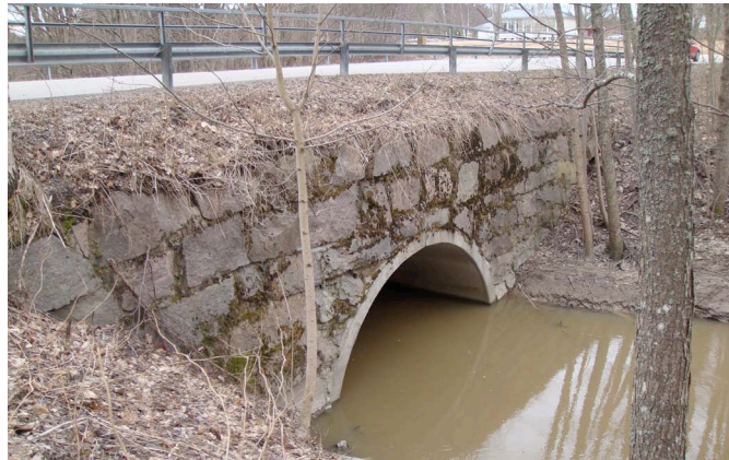
Storkyrkovägens bro är byggd år 1985 och dess behov av grundlig reparation kan eventuellt uppstå om ca 20 år.
