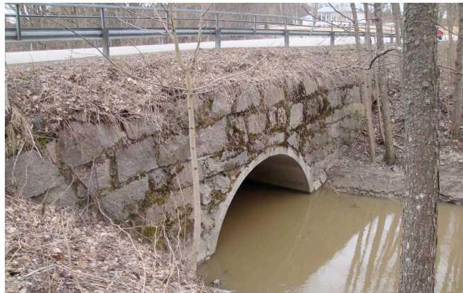
Suurkirkontien silta on rakennettu vuonna 1985 ja sen peruskorjaustarve on arviolta noin 20 vuoden kuluttua.
