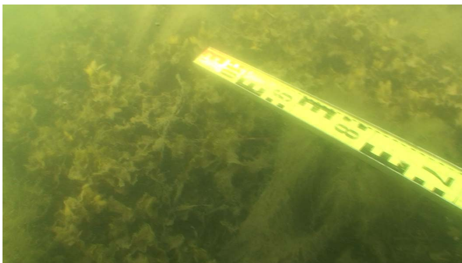
Bild 32. Brutna spant täckta av växtlighet. Foto Rami Kokko.
