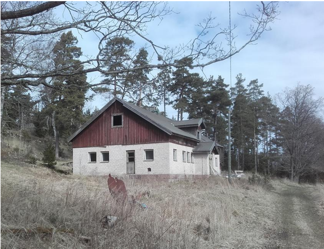
Bild 8. Ladugården (7) är till konstruktionerna i acceptabelt skick med kräver för att kunna bevaras märkbara insatser. Planen ger möjligheter till att den ska bevaras.
